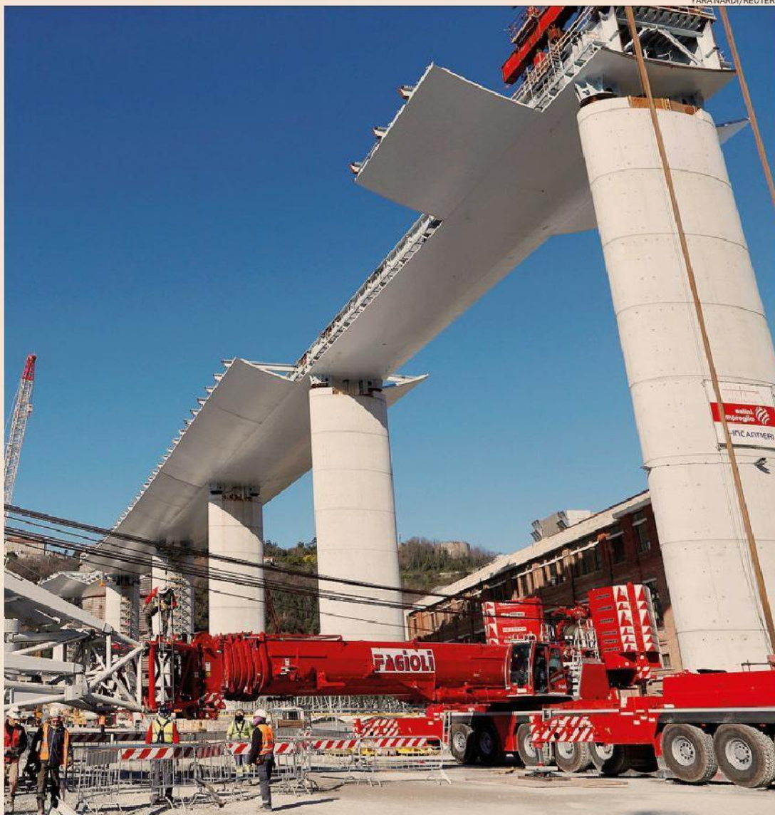
Cantiere a passo spedito. Il nuovo ponte sul Polcevera è in avanzato stato di realizzazione
